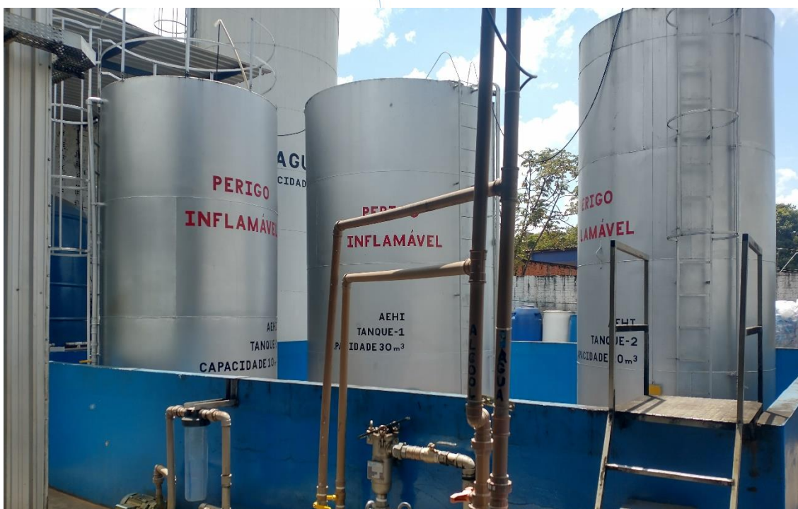
Foto 009: Depósito de inflamáveis
