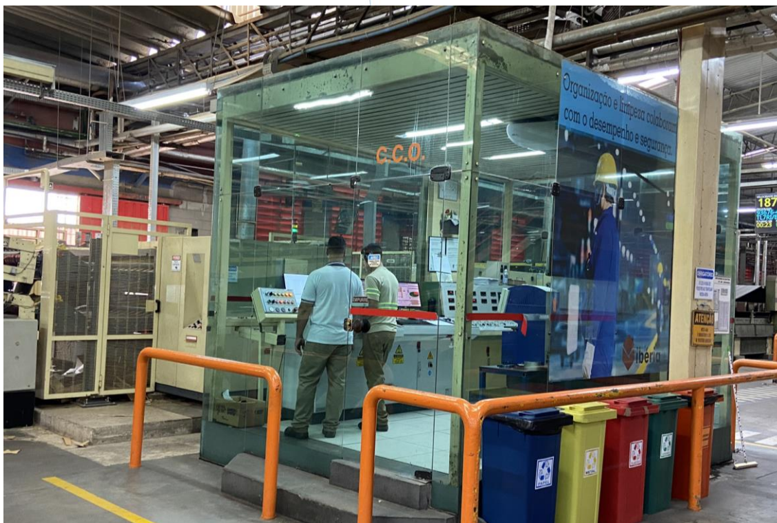
Foto 021: Sala de controle dos maquinários
