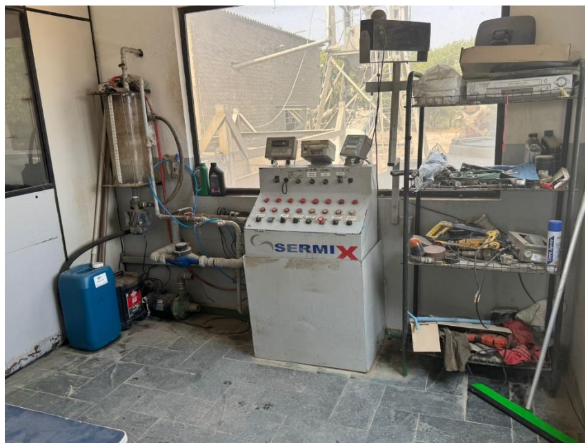
Foto 013: Sala de Controle
