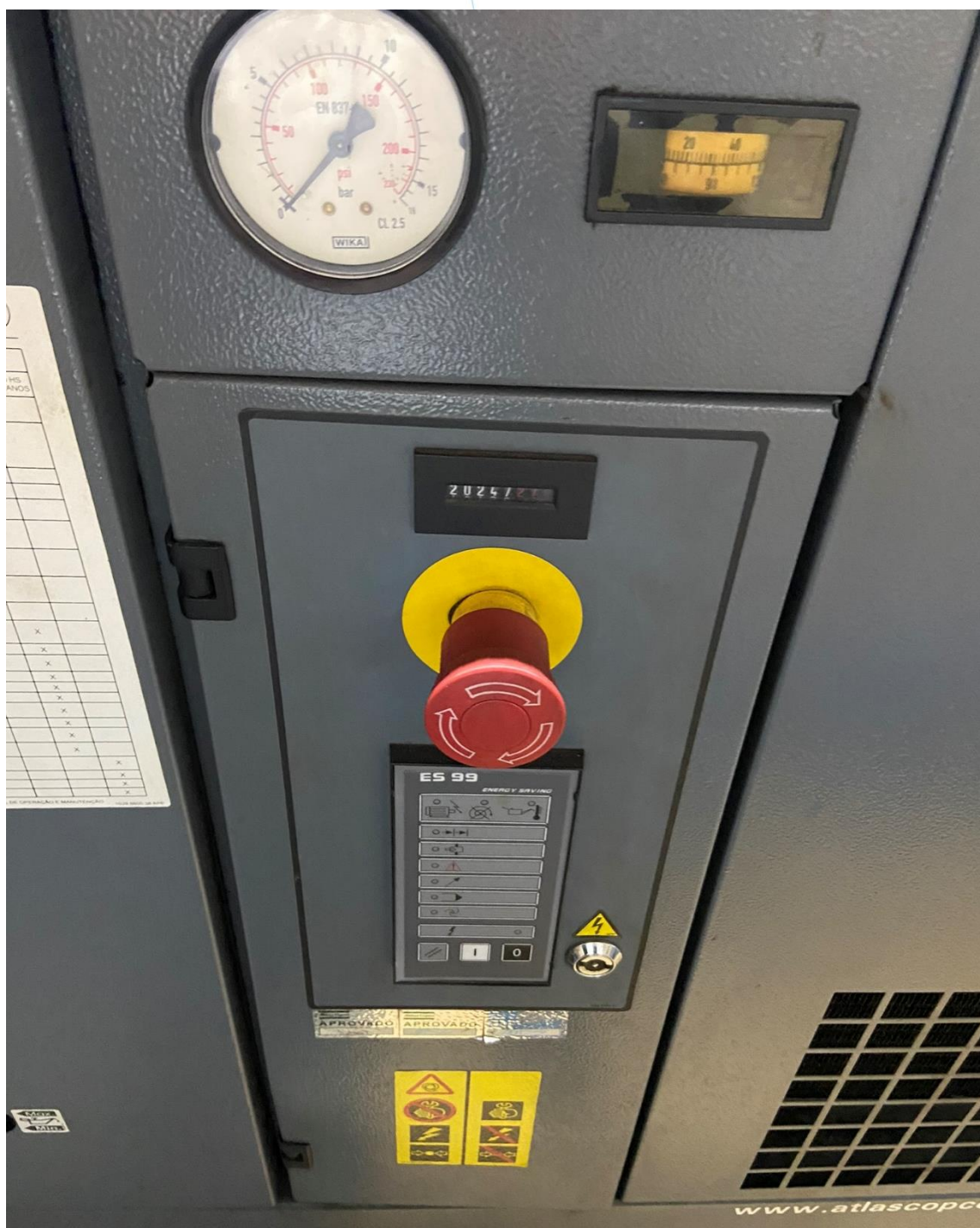
Foto 009: Compressor de ar danificado no temporal ( continuação )
