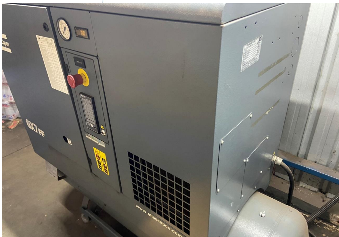
Foto 008: Compressor de ar danificado no temporal
