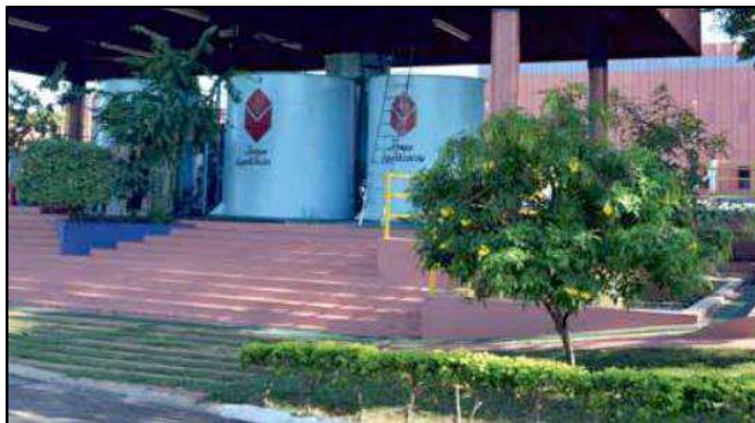
Sistema de tratamento de efluentes
