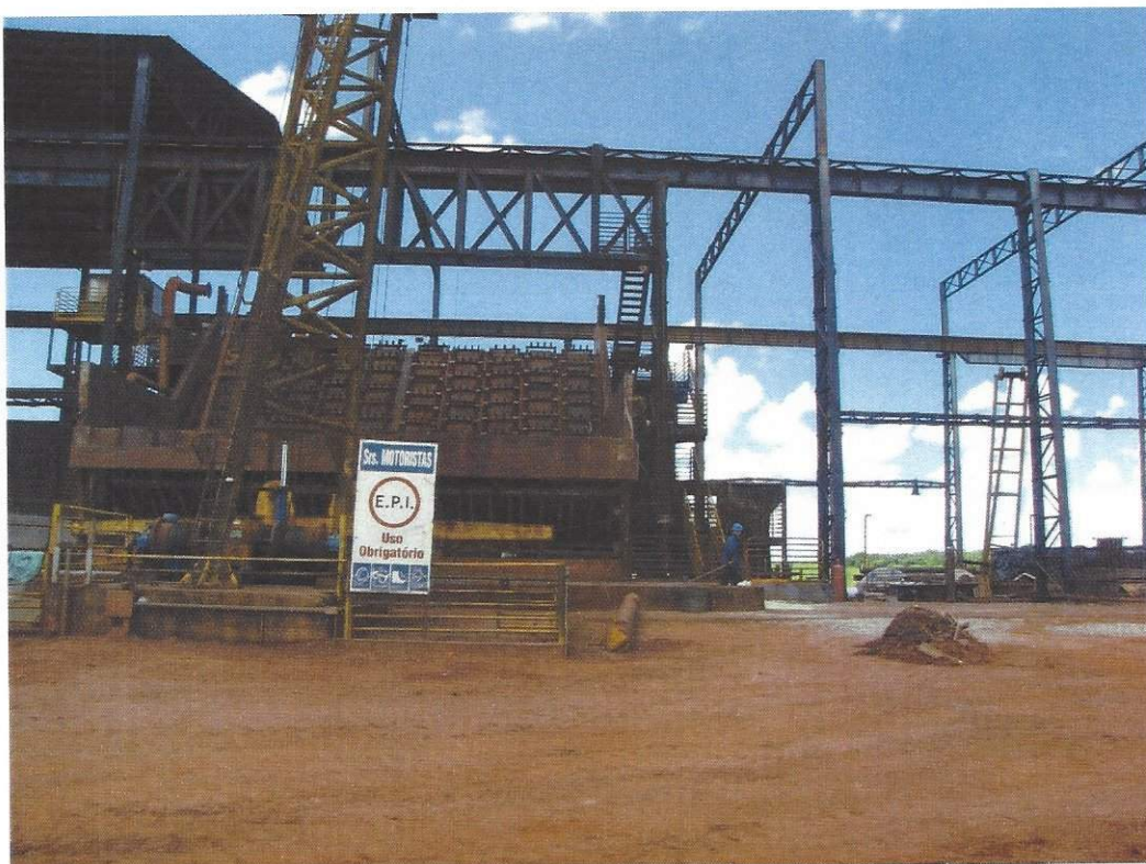
04-Moenda em manutenção para início da safra
